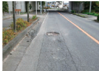
▲道路の陥没・穴
