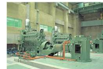
北浜田排水ポンプ場 (排水ポンプ)
