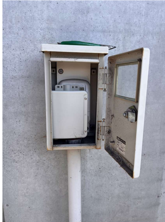
設置先：官公署施設 カウンターポール内への設置 (メーターはメーターボックス内へ設置)
