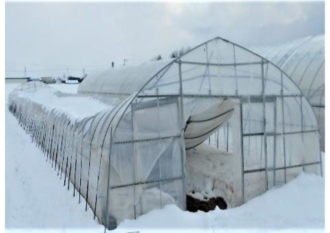
＜雪による被害の様子＞
