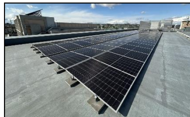
屋上太陽光パネル
