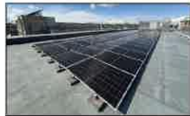
屋上太陽光パネル
