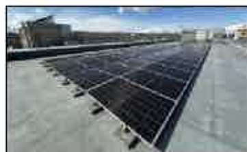
屋上太陽光パネル
