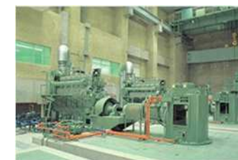
北浜田排水ポンプ場（排水ポンプ）
