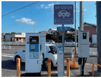
EVステーションの一例
