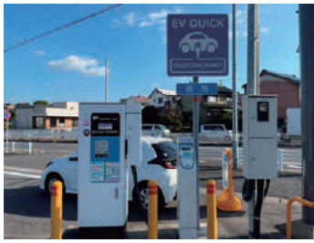
EVステーションの一例
