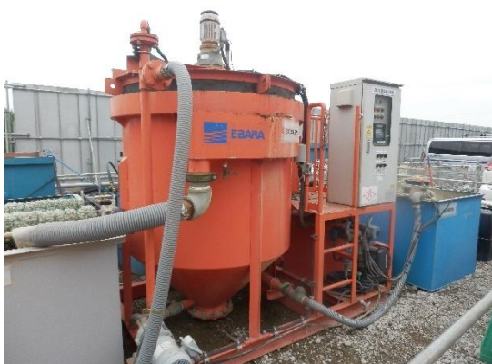
写真 4 : 排水ろ過設備の状況
