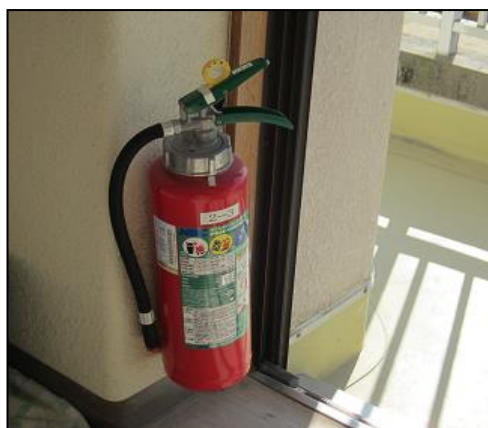
<廊下に設置された消火器>
