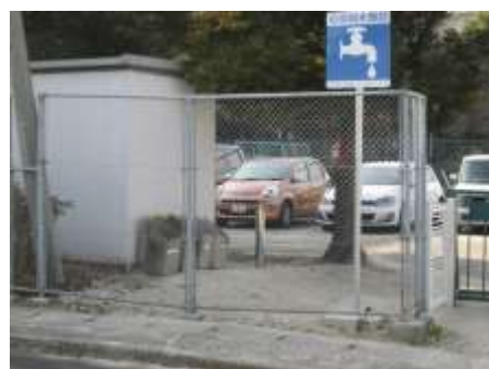
<乙川小学校に設置した応急給水栓>
