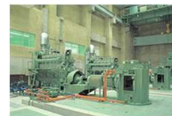
北浜田排水ポンプ場（排水ポンプ）
