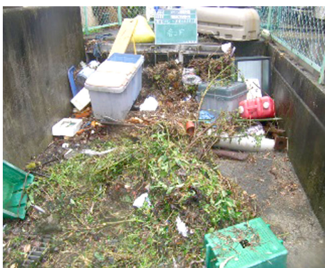
▲水路の詰まり
