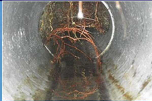
汚水管に侵入した樹木
