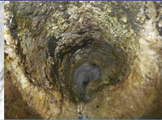
油の付着した汚水管
