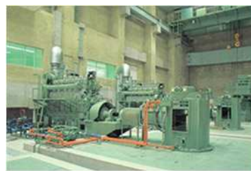
▲ 排水ポンプ (北浜田排水ポンプ場)
