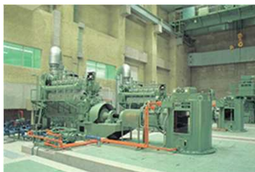
▲排水ポンプ（北浜田排水ポンプ場）
