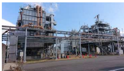
▲ 衣浦西部浄化センター汚泥焼却施設
