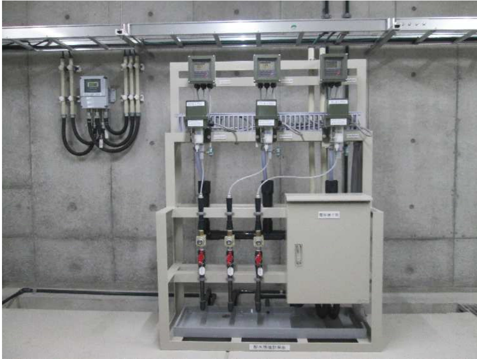
(無試薬形残留塩素計：砂谷配水場)
