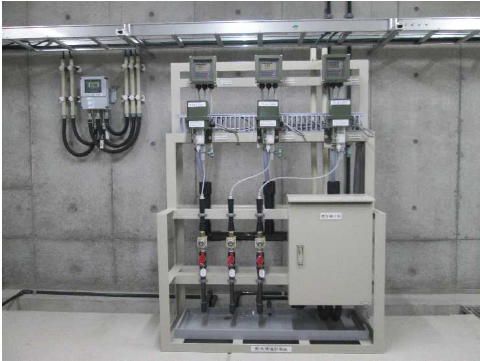
(無試薬形残留塩素計：砂谷配水場)
