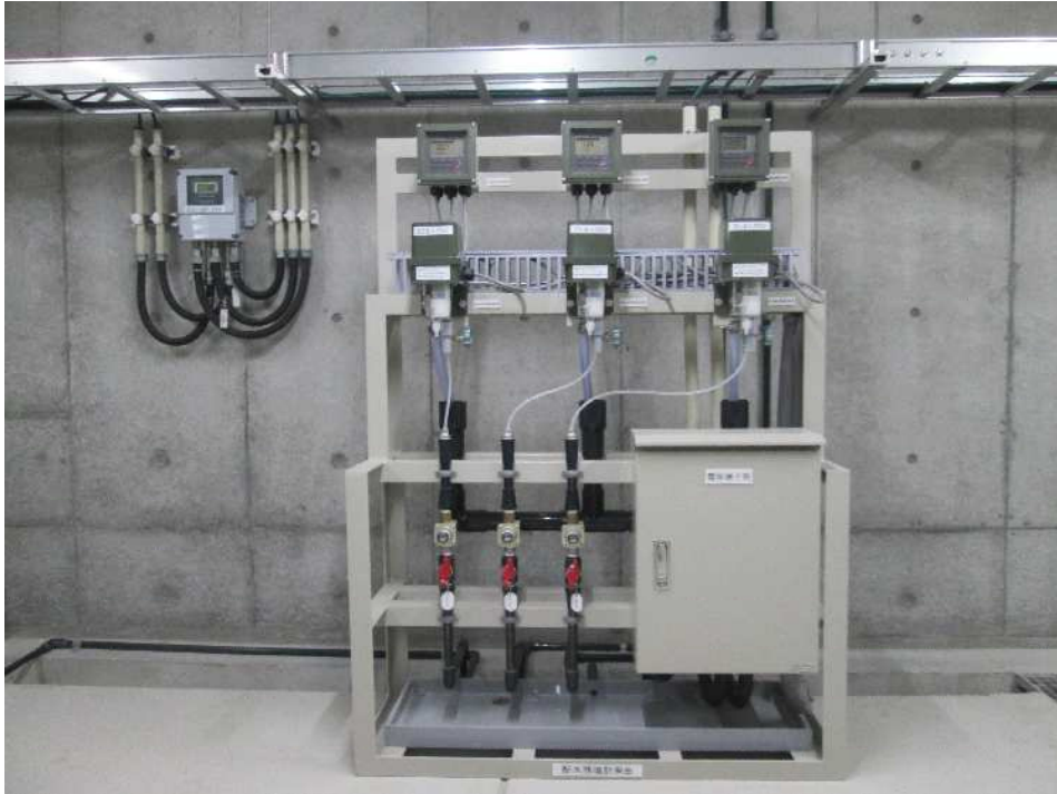
(無試薬形残留塩素計：砂谷配水場)
