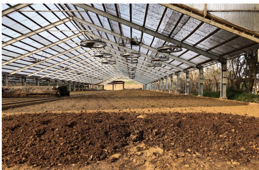
写真5-1 増設した送風機の様子
