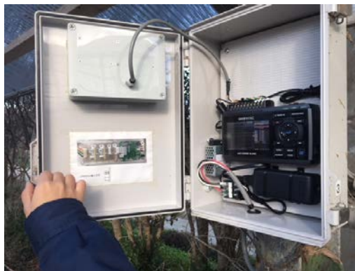
写真 2-2 ガスセンサ設置ボックス内部
