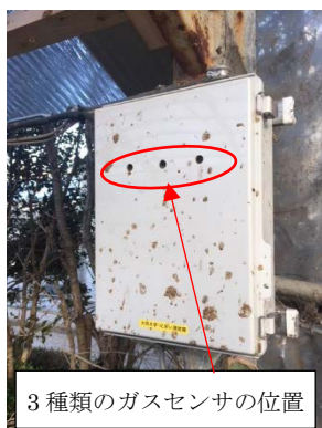
写真 2-1 ガスセンサ設置ボックス外観
