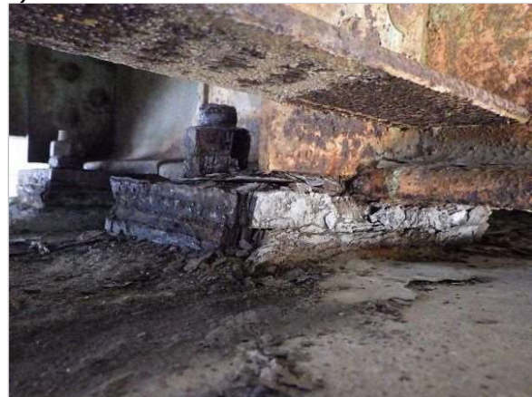
写真2 支承部の腐食(Ⅲ判定)
