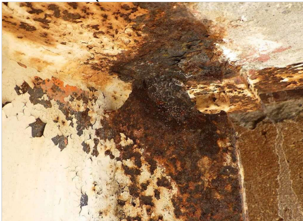
写真1 主桁の腐食(Ⅲ判定)
