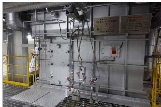
写真 5-2 熱回収施設の焼却炉
