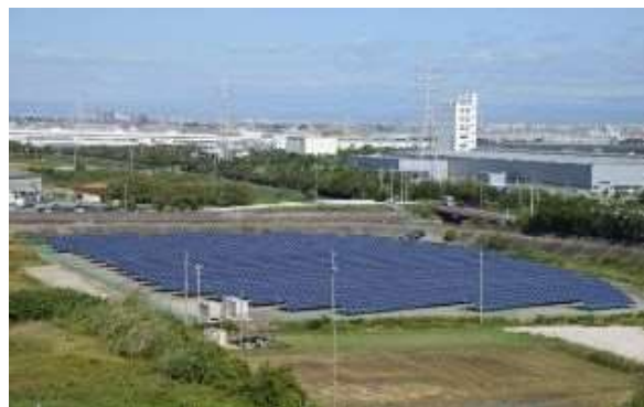
（一般廃棄物最終処分場建設予定地に設置した太陽光発電システムの様子）
