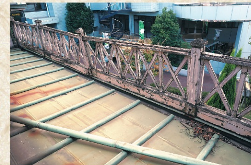
腐朽して崩れそうなベランダの手すり
