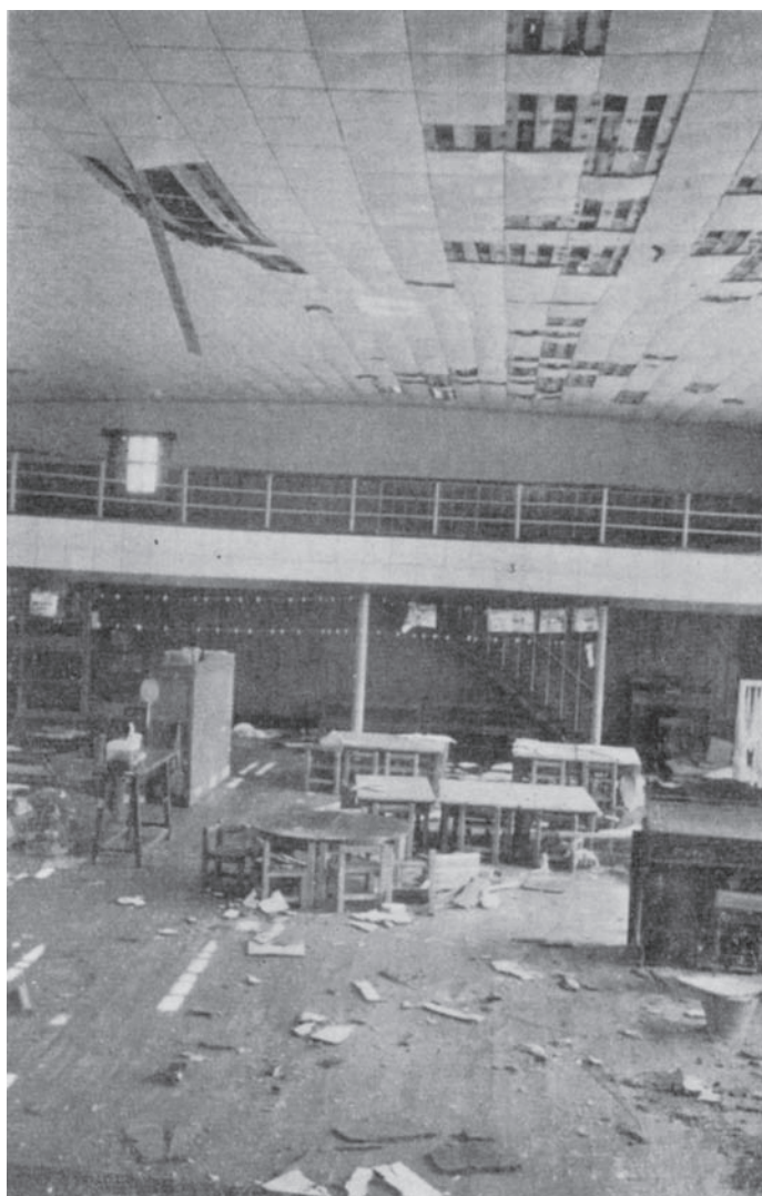
こわれた亀崎幼稚園の遊戯室
